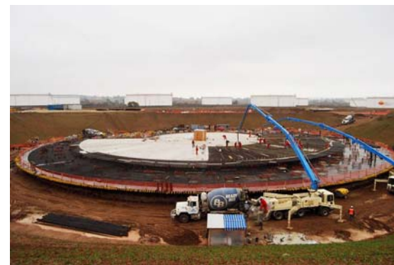
Estanque principal T-101
