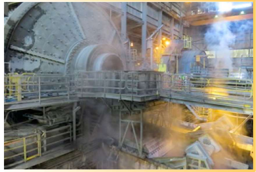
Minera Candelaria, pasarelas, molienda SAG, 2008
